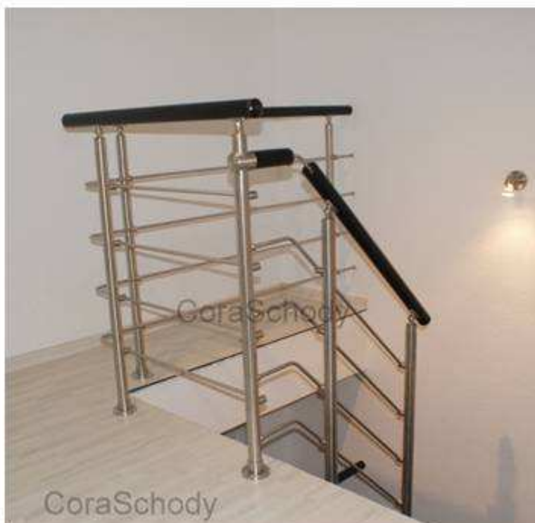
Balustrada ochronna otworu;
